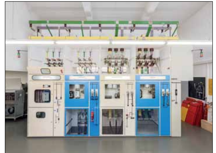
Die Schaltanlage der DEW21 in Dortmund-Asseln
