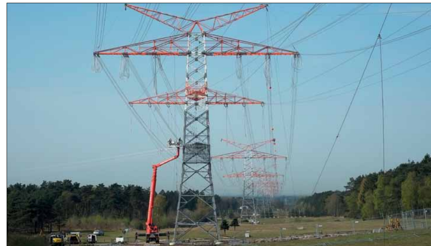
Freileitungen (oben), die Amprion-Zentrale in Dortmund (rechts)
