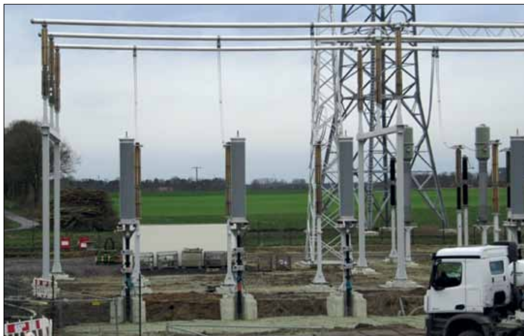
380 KV- Endverschlüsse an der Übergangsstelle zur Freileitung
