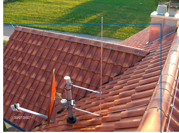
Eine isolierte Fangstange schützt die SAT-Antenne. (Quelle: DEHN)
