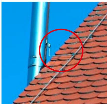
Metallenes Abgasrohr ist an die Fangeinrichtung angeschlossen, weil der Trennungsabstand nicht eingehalten wurde. (Quelle: VDE)
