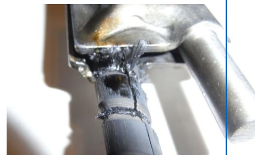
CFK-Stab nach Blitzstrombelastung (Quelle: DEHN SE)
