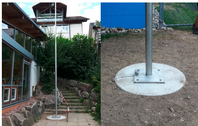
Bild 7: Fangmast mit Betonsockel (rechts: Betonsockel mit Anschlussfahne der Erdungsanlage) | M. Rhein
