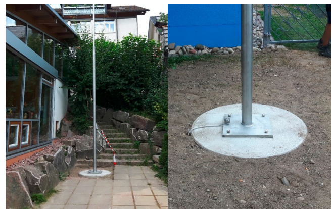
Bild 4: Fangmast mit Betonsockel (rechts: Betonsockel mit Anschlussfahne der Erdungsanlage) | M. Rhein
