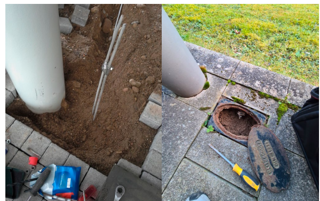
Bild 3: Tiefererder mit Anschlusskasten | M. Rhein
