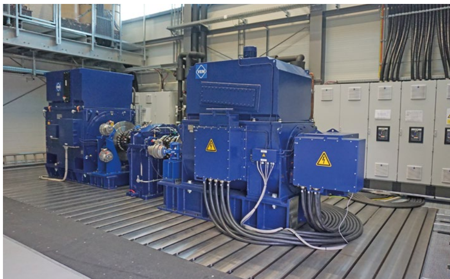
Bild 2: Foto der gekoppelten Maschinen und des Anschlussfeldes während der Inbetriebnahme
