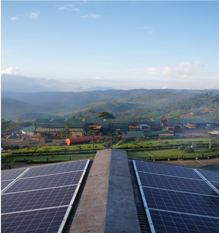
Bildunterschrift: PV-Hybrid Installation in Rwanda (Bildquelle: OneShore Energy GmbH)
